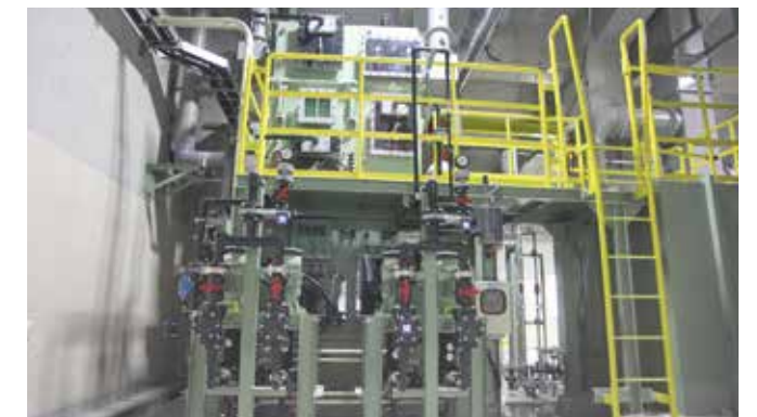
生物脱臭塔・薬液洗浄塔
